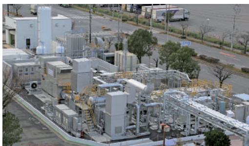
ポートアイランドに建つプラント 「水素コージェネレーションシステム」
